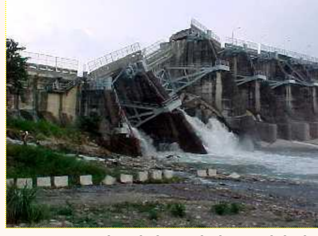
Deprem nedeniyle yıkılmış bir baraj (Towhata, 2008)
