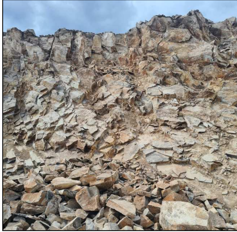
Şekil 3. Çatlaklı ve çatlak araları açık-kapalı bir yapıya sahip Karacaören bazaltların ocakta açılan yüzeydeki görünüşü.
