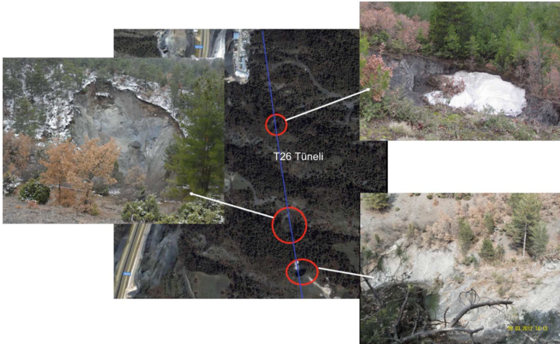
Şekil 4. Aşırı kazı sonucu oluşan obruklar.
