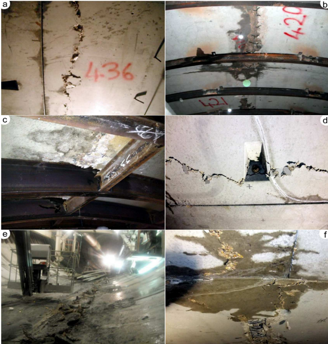
Şekil 5. Beton Prekast Segmentlerde yaşanan deformasyon ve kırıklar (a: Tünel eksen bölgesinde yaşanan boyuna çatlaklar, b: Segment birleşim yerlerinde oluşan çatlaklar ve demir donatıların görünüşü, c: segmentlerde kopma, d: Segment birleşim yerlerinde oluşan kırıklar, e: tünel tabanında oluşan kabarmalar, f: obruk bölgesinde segmentlerde oluşan çatlakların ardından su gelişi).
