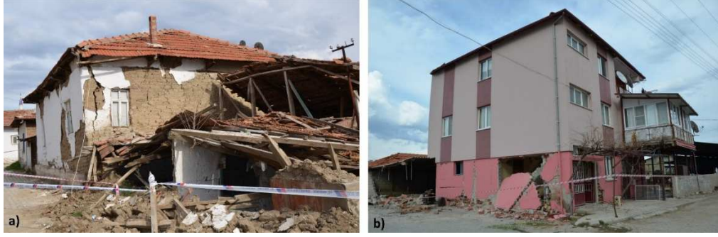
Şekil 8. 20 Mart 2019 depreminde a) Karahüyük köyünde kerpiç binada, b) Apa köyünde betonarme yapıda meydana gelen ağır hasarlar.
