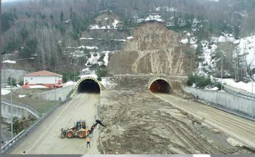
BOLU DAĞI TÜNEL PORTAL HEYELANI
