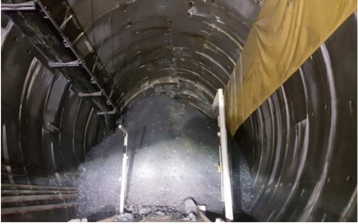
Şekil 8. 566.- 567. Numaralı segmentlerde yaşanan (~1132. m) yenilme ve sonrasında oluşan göçük.
