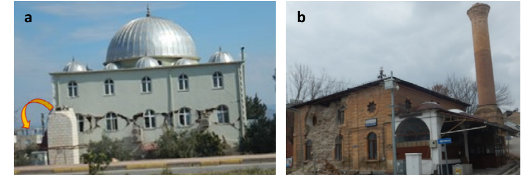
Şekil 12. Kubbeli ve minareli yapılar olarak deprem bölgesinden: (a) İslahiye'de minaresi devrilmiş ve hasarlı bir cami ve (b) Göksun tarihi Ulu Cami (Ulusay vd., 2023)
