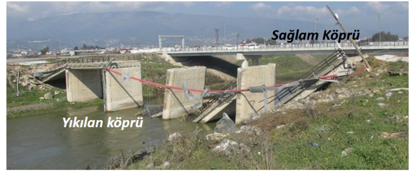
Şekil 16. Hatay Eğitim ve Araştırma Hastanesi yakınındaki yıkılmış ve diğeri hasarsız köprü (Ulusay vd., 2023)
