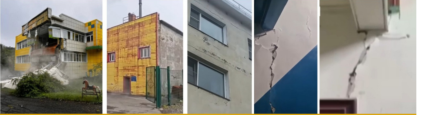
Şekil 12. Sovyet dönemi inşa edilen betonarme prefabrik yapılarda gözlenen hasarlar (değişik internet kaynaklarından)
