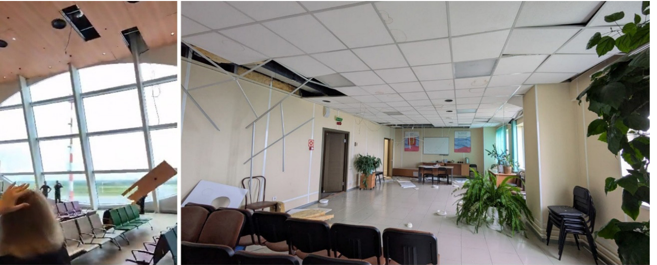
Şekil 14. Havaalanı bekleme salonu ile Petropavlovsk şehrinde bir ofis binasında askı tavan hasarları (değişik internet kaynaklarından)
